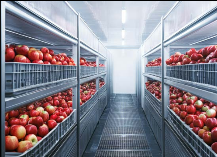
Kühlhäuser und Tiefkühlager
